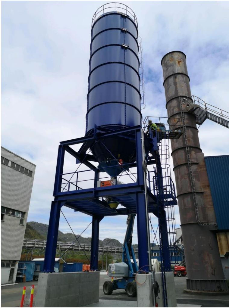
Silo i bultad konstruktion. Breddat benstativ med utlastning till bulkfordon.
